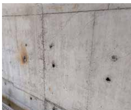
4. Andamento fessure setti laterali
