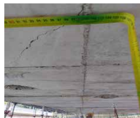
6. Dettaglio fessure intradosso soletta cassone
