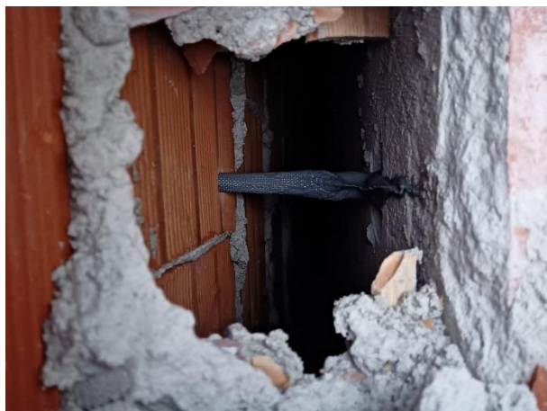
Vista della bussola saturata di resina
