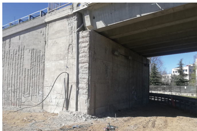
6A, 6B e 6C. Il ripristino del pulvino e il degrado della spalla e del muro di risvolto
